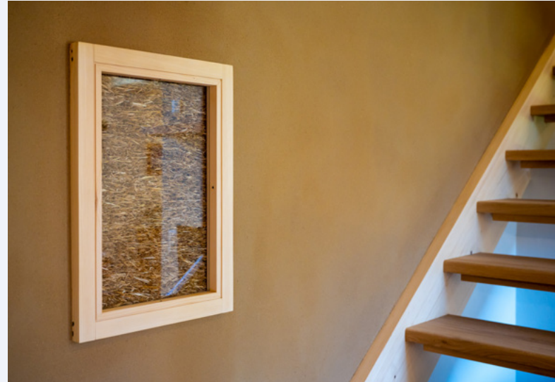
L'ossature est une construction en bois remplie de paille et enrobée d'argile pour une bonne isolation thermique.
